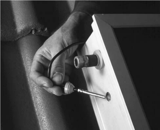
Bild 29 Stopfen aus Fühlerhülse nahe Kollektorfeld-Austritt ziehen und auf Fühler schieben. Fühler in Absorber-Hülse stecken und wieder verschließen. Kabel durch Lüfterziegel zur Fühlerdose legen.
