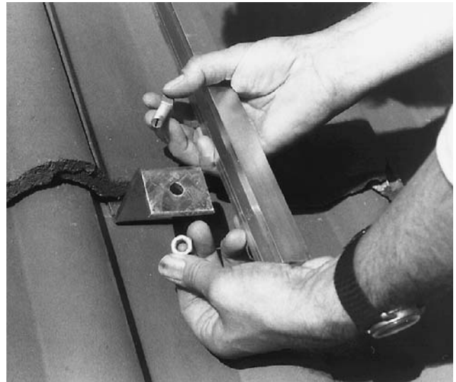
Bild 4 Eine sichere Dachverbindung mit Montageschiene, Hammerkopfschraube und Sparrenanker (hier Typ „P“ für Frankfurter Pfanne und ähnliche Formen).
