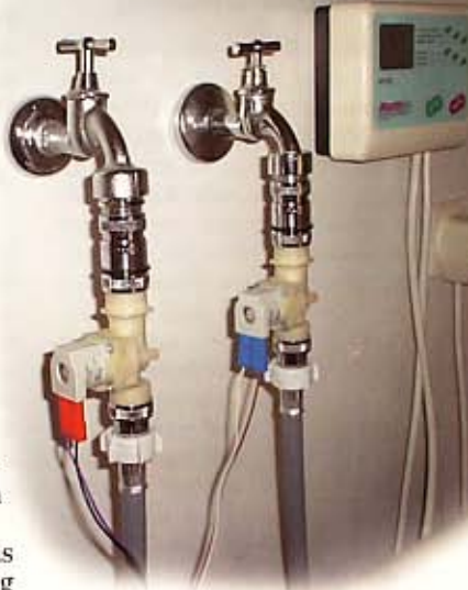
Bild 1: Links der Warmwasser- und rechts der Kaltwasseranschluss, im Hintergrund das Vorschaltgerät
